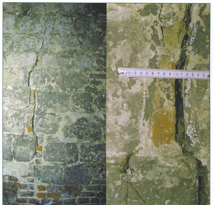
Fissure dans le mur est du clocher
